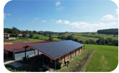
Chemin du Mas (42) - 128 kWc de puissance installée
